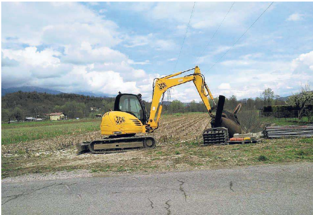
La ruspa a Mugnai per l'avvio dei lavori della vasca di laminazione
